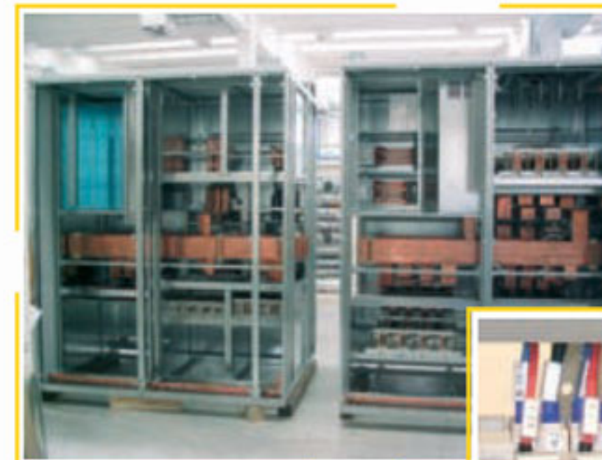
Quadro elettrico di distribuzione "Power Center" per grossi impianti con propria cabina di trasformazione realizzabile con segregazione in "forma 4" secondo CEI EN 60439-1.
